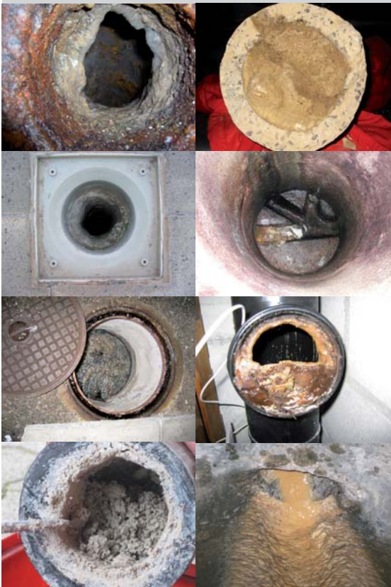
Verstopfungsursachen: Ablagerungen, Kalk, Schlamm
