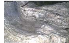
Massive, harte Verkalkung staut das Wasser.
