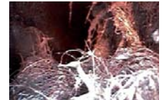
Wurzeleinwuchs verengt Rohre und macht sie undicht.
