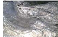
Massive, harte Verkalkung staut das Wasser.
